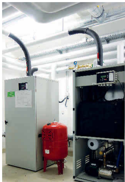
Bild 3 Regenwassercenter Tano XL zur Unterverteilung des Betriebswassers nahe bei den Verbrauchsstellen. Bei fehlendem Niederschlag erfolgt automatisch im Regenwassercenter die Nachspeisung gemäß DIN EN 1717. Foto: Mall
