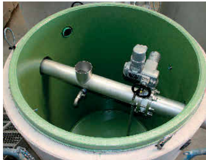
Bild 2 Der Blick ins Sicherheitsauffangbecken zeigt Durchverrohrung, Absperrklappe mit Schwenkantrieb und Überlaufstutzen. Foto: Mall
