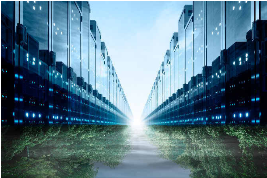
Abwärmestrom von Rechenzentren ist unterbrechungsfrei und stellt daher eine sehr zuverlässige Quelle sauberer Energie dar. Foto: Danfoss
