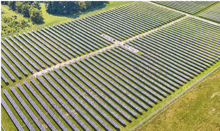
Für Betreiber von Solarparks- und -anlagen bietet Iqony diverse Dienstleistungen, von der Planung und Realisierung, über den technischen Betrieb, bis hin zum Monitoring und Management von Anlagen. Foto: PantherMedia/njproductions
