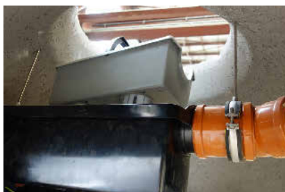
Ein unterirdischer Regenspeicher nach Einbau: Der Blick geht von unten in Richtung geöffneter Abdeckung und Filterkasten, der zur Reinigung entnommen wird. Der schwarze Filterwannen-Zulauf ist links zu sehen, der Überlauf befindet sich nach rechts auf gleicher Höhe. Hier ist kein Geruchverschluss notwendig, da nicht in den Kanal entwässert wird. Foto: Mall
