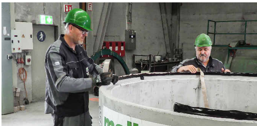
Ein unterirdischer Regenspeicher wird vorbereitet. Hier wird das Dichtungsband in der Fuge des Betonbehälters eingelegt. Nach Verschrauben mit dem konischen Oberteil und Fertigstellen sämtlicher Einbauten kann der Kran des Lieferfahrzeugs den Speicher direkt in die Baugrube versetzen. Foto: Mall
