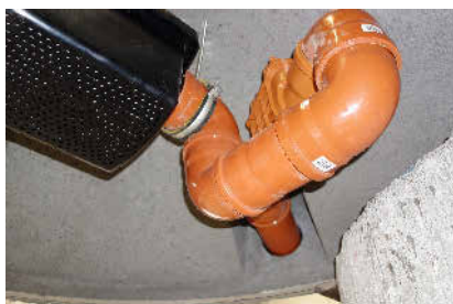
Der Konus für einen unterirdischen Regenspeicher beim Einbau im Gelände. Zu sehen sind auch die vormontierte schwarze Filterwanne und der Überlauf inklusive Geruchverschluss und Rückstauverschluss, da in den Kanal entwässert wird. Foto: Mall
