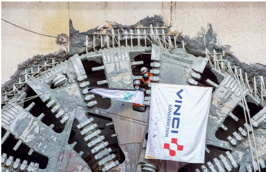
Aufgrund der guten Zerspanbarkeit von Combar fährt die Tunnelbohrmaschine nahtlos durch die Schlitzwände. Foto: Société du Grand Paris / David Delaporte
