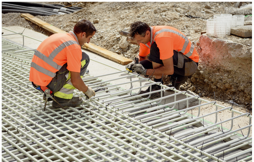
Durch die Bewehrung der Gleistragplatten der Tram in München mit Combar konnten Signalstörungen vermieden werden. Foto: Moritz Bernouilly
