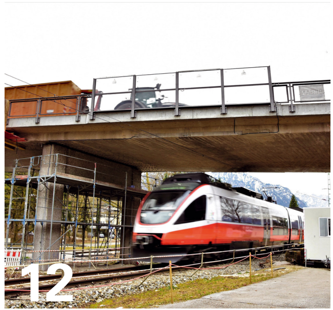
12 Die Brücke in Bad Reichenhall konnte mit eingeklebten Betonschrauben bei laufendem Verkehr verstärkt werden. Foto: Würth
