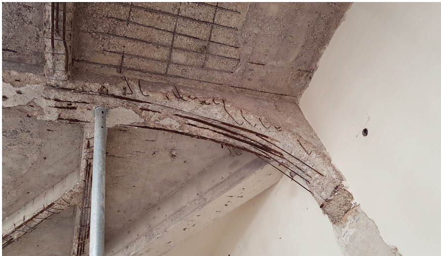
Bild 4. Freigelegte Bewehrung der Kragarme. Foto: Würth
