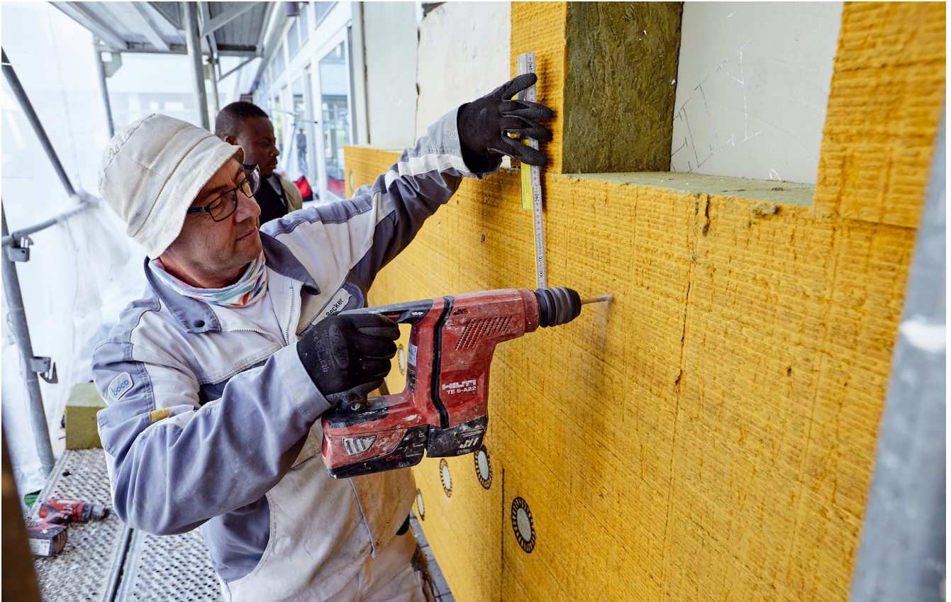
Die Dämmplatten weber therm circle werden mechanisch mit Schraubdübeln an der Fassade befestigt. Dies erleichtert den Rückbau. Foto: Saint-Gobain Weber
