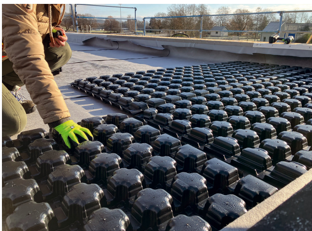
Bild 6. Retentions-Gründach Sponge City Roof. Oberhalb Dämmung und Dichtung 8 cm hohe Spacer-Elemente mit Hohlräumen für flächigen Wasserspeicher mit einem Volumen von 19,2 m 3 und einer maximalen Last von 80 kg/m 2 . Dies liegt noch deutlich unter der für den Winter zu berücksichtigenden Schneelast vor Ort. Foto: Mall
