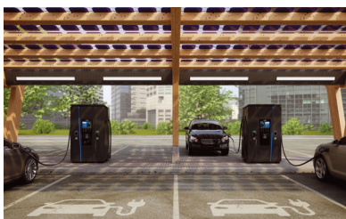
Das hochmoderne Stromverteilungssystem des eTower – auf Basis von sieben unabhängigen Leistungsmodulen – verteilt den Strom dynamisch und intelligent. Foto: Compleo
