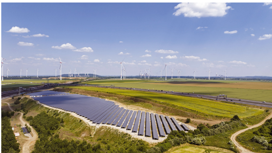
Photovoltaik-Anlage von RWE im Rheinischen Revier. Foto: RWE
