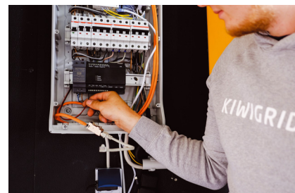
Mithilfe des Energy-IoT-Gateways Energy Manager RailX lassen sich Energieflüsse intelligent steuern. Foto: Kiwigrid
