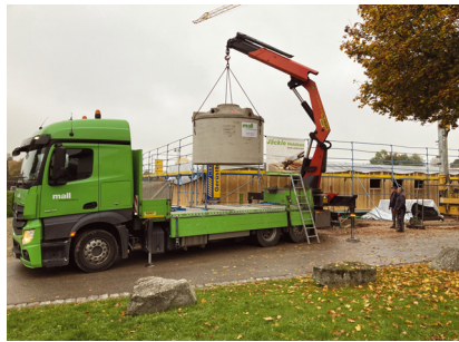
Der unterirdische Regenspeicher aus Betonfertigteilen, mit integriertem Filterkorb im Zulauf und werkseitig vormontierten Wanddurchführungen für Zu- und Überlauf sowie einem Leerrohr als Verbindung zum Regencenter im Gebäude wird angeliefert. Foto: Mall
