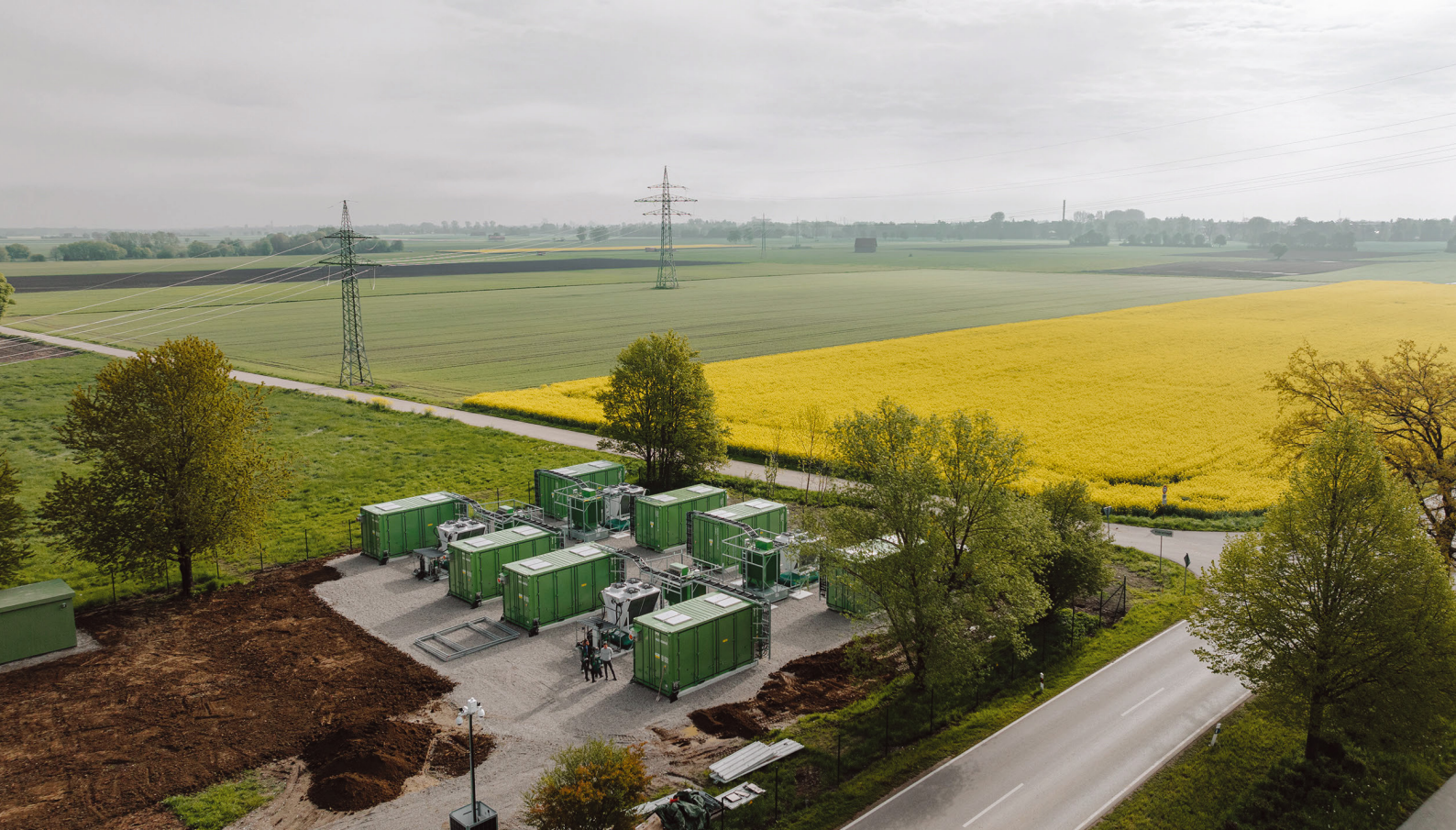
Batteriegroßspeicher – Beispielprojekt Kyon Energy. Foto: Kyon Energy
