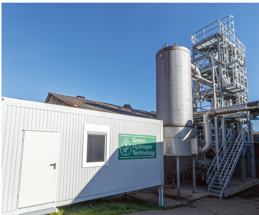
In dieser Pilotanlage in Leoben, Österreich, skaliert das Start-up Green Hydrogen Technology (GHT) sein Wasserstoffherstellungsverfahren für die industrielle Anwendung. Foto: GHT
