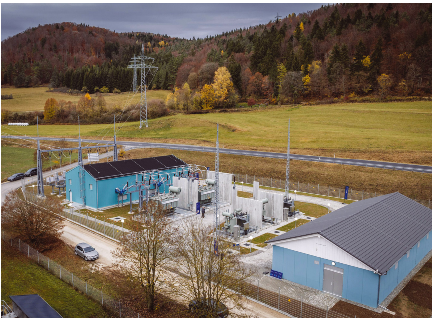
Innovative Technik im neuen Umspannwerk im baden-württembergischen Burladingen.
