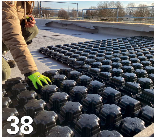
Ein neues Gebäude in Baden-Württemberg fängt Regenwasser vollständig auf und nutzt es zur Begrünung und WC-Spülung. Das Besondere: Fast die Hälfte des Wassers verdunstet wie im natürlichen Gelände vor der Bebauung. Foto: Mall
