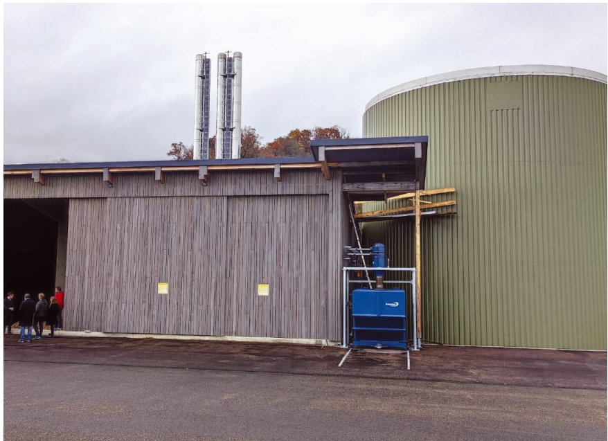
Heizzentrale in Ammerbuch-Breitenholz, rechts der Pufferspeicher. Foto: PEE BW
